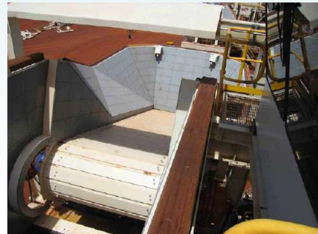
TTMS Apron Feeder
